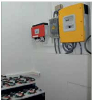
Solar-Akku-Anlage mit Speicher und Frequenzumrichter (Garage)
