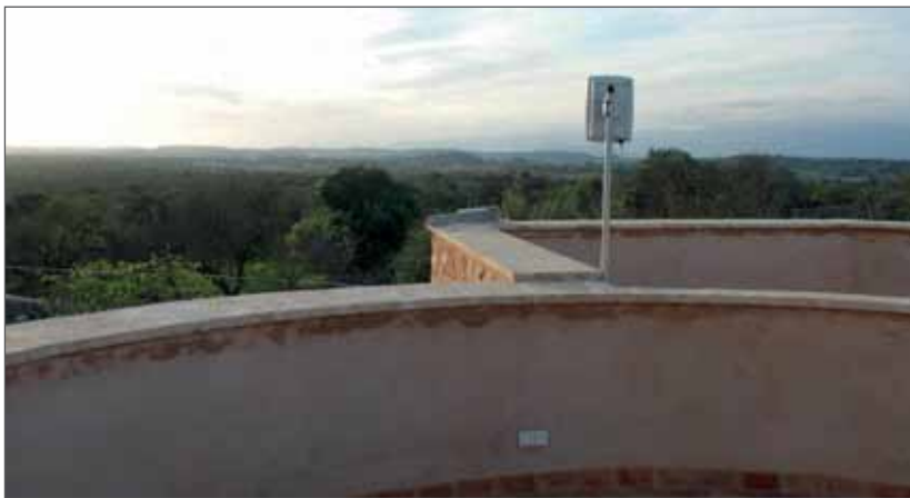
Richtfunkantenne für Internetanschluss und Telefonie (Richtung Palma)
